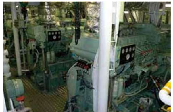
発電機関／Engine for generator
