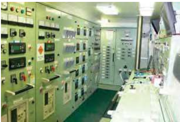
機関制御室／Engine control room
