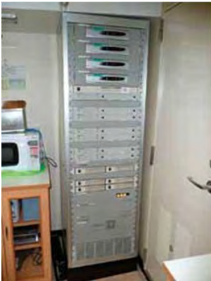
映像配信装置／Television image transmitter system
