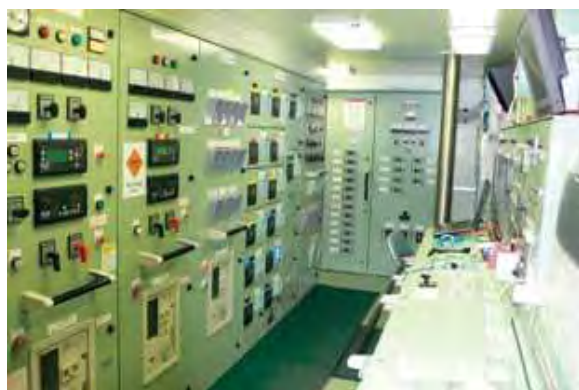
機関制御室/ Engine control room
