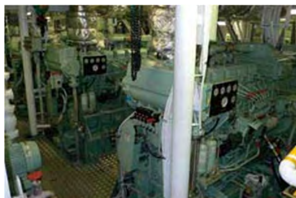
発電機関/ Engine for generator
